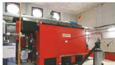
Chaudière bois 1,25 MW avec décentrage automatique
